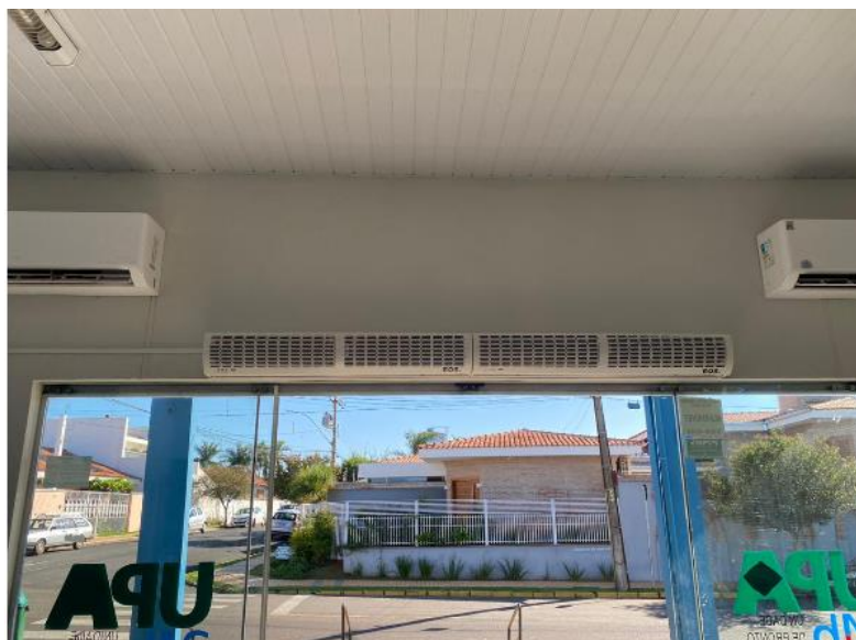
Foto 1 – 2 cortinas de ar instaladas na porta de entrada da sala de espera UPA
