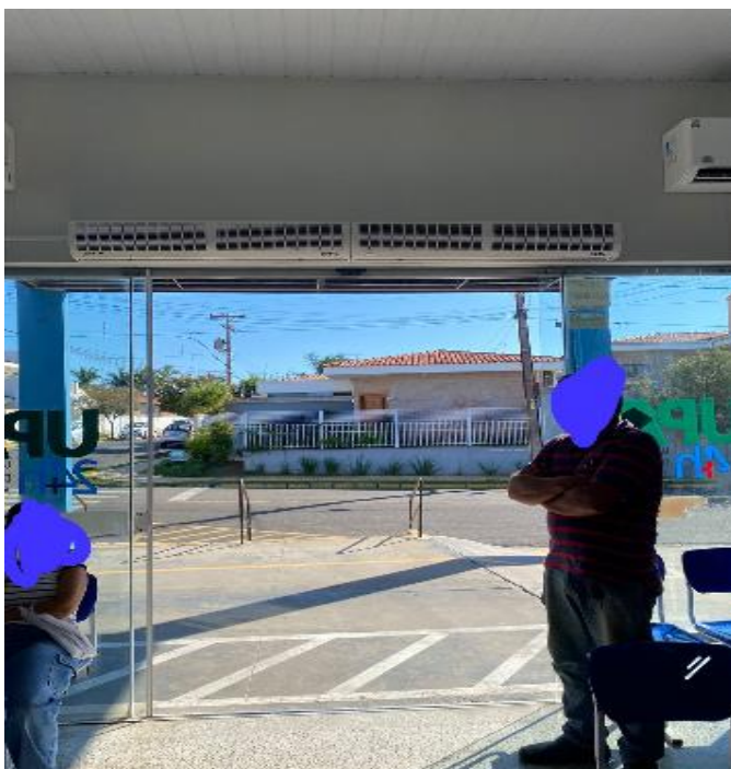
Foto 2 - 2 cortinas de ar instaladas na porta de entrada da sala de espera UPA
