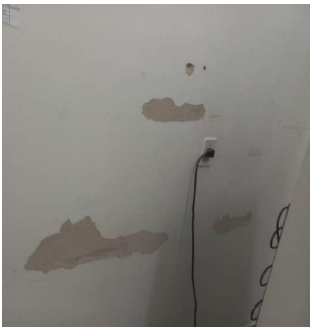
Localização de áreas danificadas.
