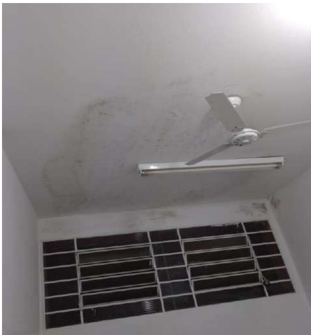
Localização das áreas danificadas.
