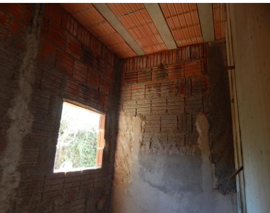
Imagem 06 – parcial sanitário inacabado
