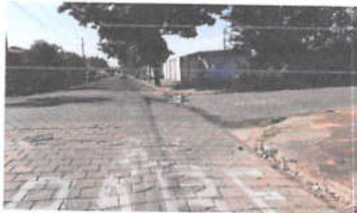
Figura 4.4.86 – R Cel Joaquim Piza, esquina com a R Mario Marangão, onde ocorrem empoçamentos
