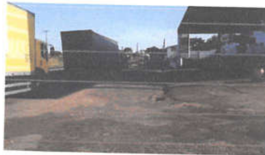
Figura 4.4.48 – Av Presidente Vargas, em frente ao posto Angélica, onde ocorrem alagamentos durante precipitações intensas
