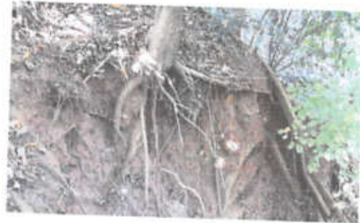
Figura 4.4.127 – Água acumulada adjacente ao dissipador de drenagem em gabião na R Sete de Setembro
