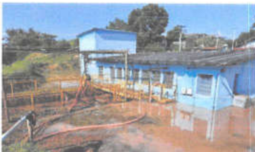
Figura 4.1.7 – Alagamento ocorrido na ECR B1 em 19 de fevereiro de 2022
