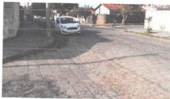
Figura 4.4.115 – R General Glicério, esquina com a R Júlio Prestes, em vista do trecho entre a R Quinze de Novembro e a R Fausto Floriano, onde há empoçamento durante precipitações intensas
