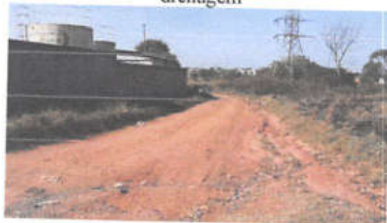
Figura 4.4.67 – Av Vererador Anézio Telles, da R Valter Alves de Souza até a R Maria Conceição Santos Silva que recebe águas pluviais de várias ruas e não possui rede de drenagem
