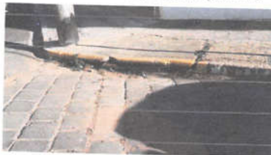
Figura 4.4.72 – Trecho sem boca de lobo esquina R Voluntários e R Heitor Penteadó
