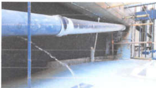
Figura 4.1.29 – Etapa de mistura rápida e coagulação realizada na ETA Garça
