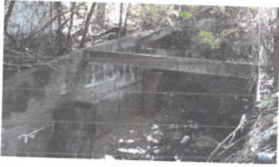
Figura 4.4.124 – Rachadura no dispositivo de drenagem da R Gabriela
