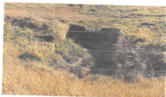
Figura 4.4.152 – Caixa de drenagem adjacente à linha férrea e próximo ao cemitério, que recebe o que é captado em tubulações de drenagem no Distrito Industrial 2
