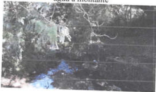
Figura 4.4.128 – Dispositivo de drenagem após a travessia na R Sete de Setembro
