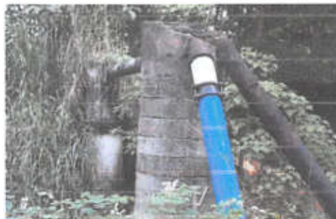
Figura 4.1.18 – Tubulação de recalque em risco devido à erosão do Ribeirão Tibiriçá
