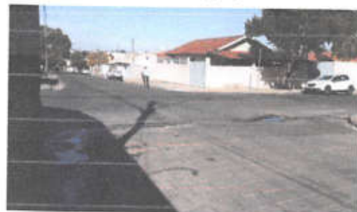
Figura 4.4.89 – R Jose Vizotto, esquina com a R Albano Vizotto, onde ocorrem empoçamentos
