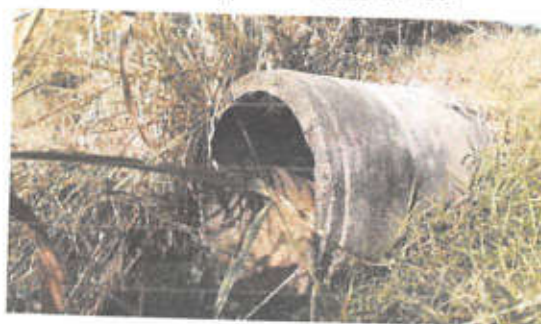
Figura 4.4.174 – Tubulação de drenagem superficial do Jd. Morada do Sol, adjacente à EP de esgoto Morada do Sol
