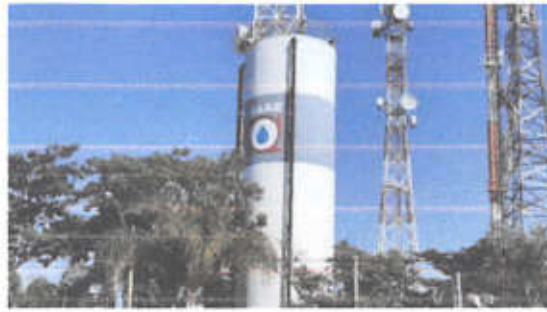
Figura 4.1.46 – Reservatório metálico Vila Araceli (CREA), de 1.000 m 3
