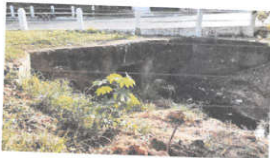
Figura 4.4.130 – Erosão em curso ao lado do dispositivo de drenagem ao fim da R Francisco da Silva Braga, comprometendo a estabilidade da alvenaria
