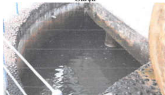
Figura 4.1.34 – Tanque em que a água da lavagem dos filtros e decantadores é armazenada até ser recirculada para a ETA Garça
