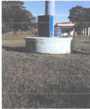
Figura 4.1.47 – Reservatório metálico Jd. Sol Nascente (Sesi), de 1.000 m 3
