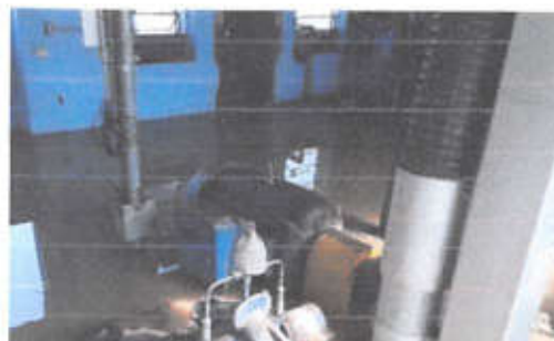
Figura 4.1.8 – Alagamento ocorrido na ECR B1 em 19 de fevereiro de 2022
