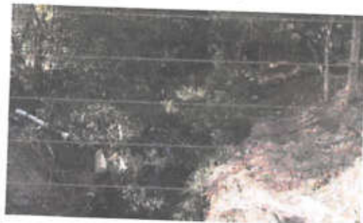
Figura 4.4.131 – Dispositivo de drenagem ao fim da R Francisco da Silva Braga, onde há uma erosão em curso devido à alteração de direção do córrego
