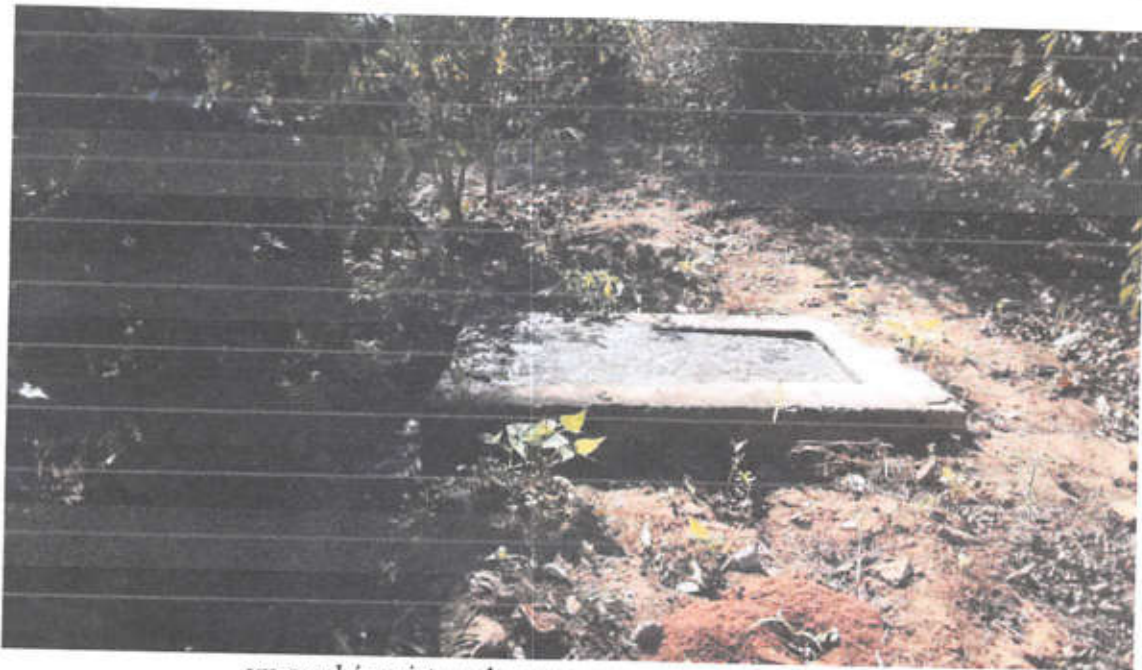
Figura 4.2.58 – Caixa de esgoto em rede próxima à esquina da Rua Tupi com a Rua São Paulo,
