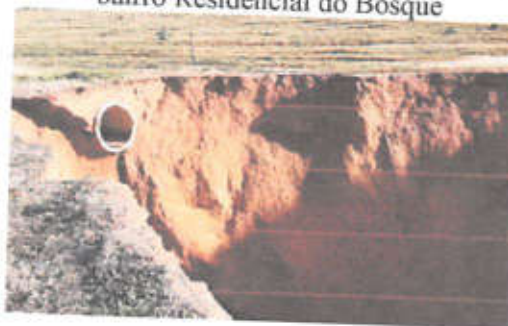
Figura 4.4.191 – Erosão na drenagem do bairro Residencial do Bosque
