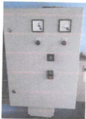
Figura 4.2.36 – Painéis elétricos dos aeradores da ETE Jafa
