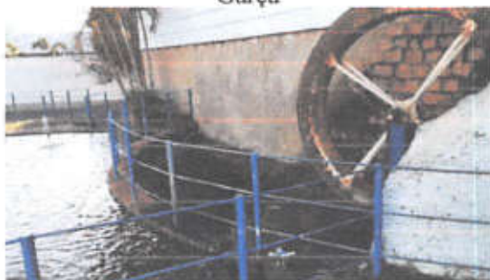
Figura 4.1.33 – Tanque em que a água da lavagem dos filtros e decantadores é armazenada até ser recirculada para a ETA Garça
