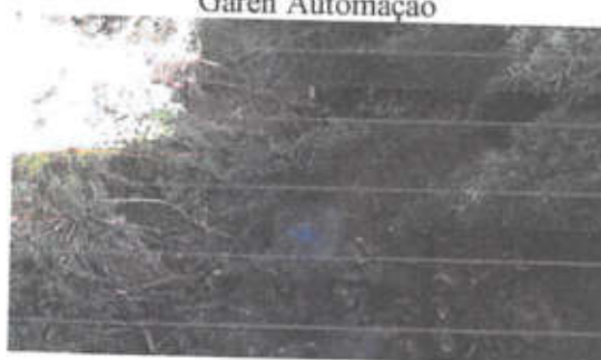
Figura 4.4.7 – Travessia do Córrego Santo Antônio sobre ponte interditada próximo à Garen Automação
