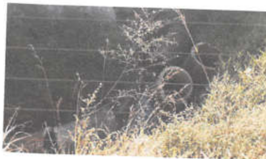
Figura 4.4.145 – Dispositivo de drenagem deslocado da rede de drenagem do bairro Nova Garça, próximo à esquina da Av Perimetral com a R Luiz Valsecchi
