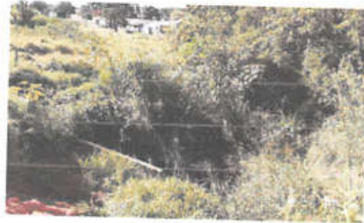
Figura 4.4.133 – Canaleta de drenagem degradada na esquina da R Tupy com a R São Paulo
