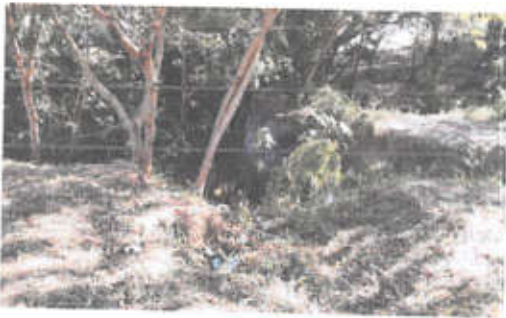
Figura 4.4.140 – Dispositivo de drenagem na esquina da R Rosário Martino com a R Luiz Valsecchi
