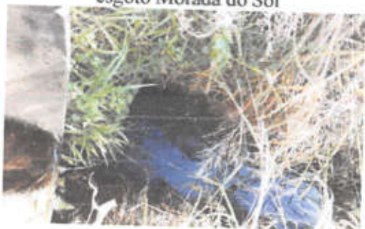
Figura 4.4.173 – Dissipador de drenagem em gabião na tubulação de drenagem superficial do Jd. Morada do Sol, adjacente à EP de esgoto Morada do Sol
