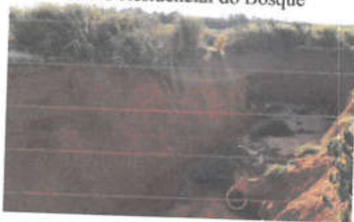
Figura 4.4.190 – Erosão na drenagem do bairro Residencial do Bosque
