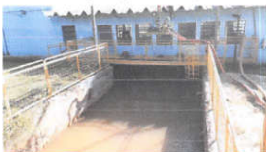
Figura 4.1.5 – Poço de sucção da ECR B1, em que se pode ver à esquerda a tubulação de entrada da água captada no Poço Guarani
