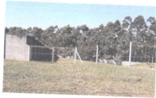
Figura 4.4.206 – Bacia de detenção do Jd. Vista Verde
