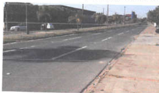
Figura 4.4.68 – Av Labieno da Costa Machado, esquina com a R Ari Rosário em trecho sem rede de drenagem em que há empocamento durante precipitações intensas
