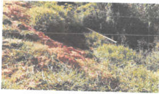
Figura 4.4.132 – Canaleta de drenagem degradada na esquina da R Tupy com a R São Paulo
