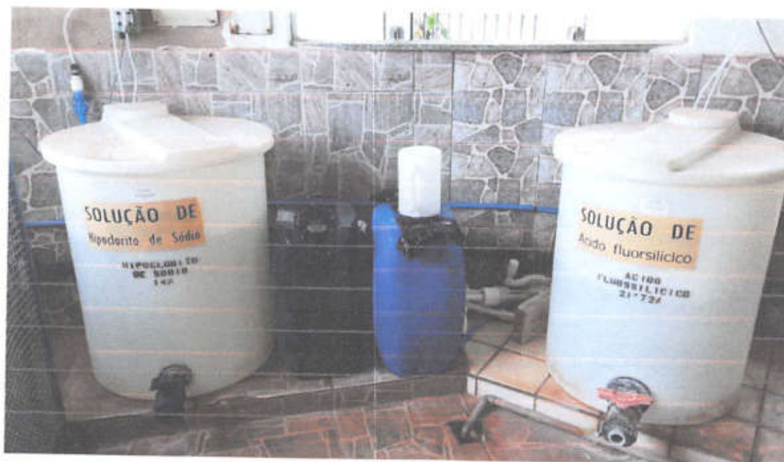
Figura 4.1.58 – Cloro e flúor utilizados nos reservatórios ETA Jafa 01 e ETA Jafa 02
